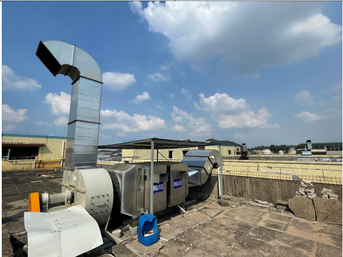
A 栋焊接烟尘废气处理措施
