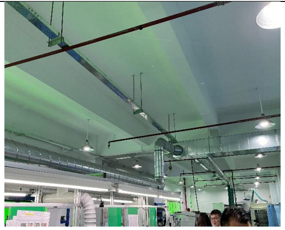
废气收集管道
